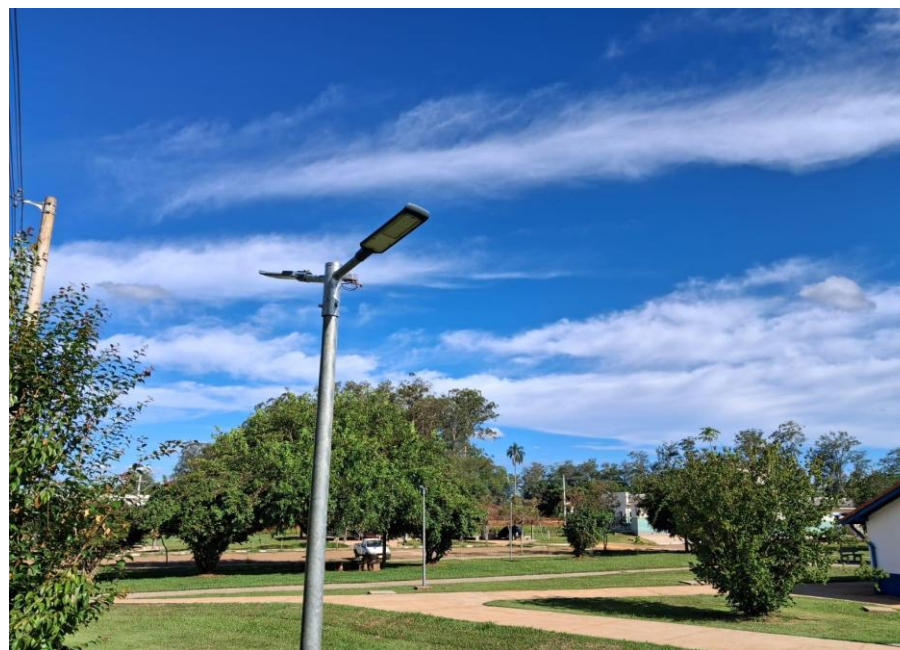
Figura 01 - Luminárias em LED instaladas. Fonte: Acervo PU-LS 2025.
